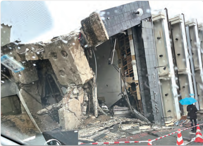
車で移動中も被災状況の確認
